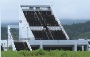
道の駅高田松原(震災遺構) 津波は高さ 14.5m(壁面左上部の印) に達したが、数名が最上部に避難し助かった。
