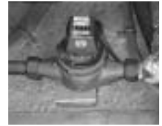
マンションの私設水メーター
