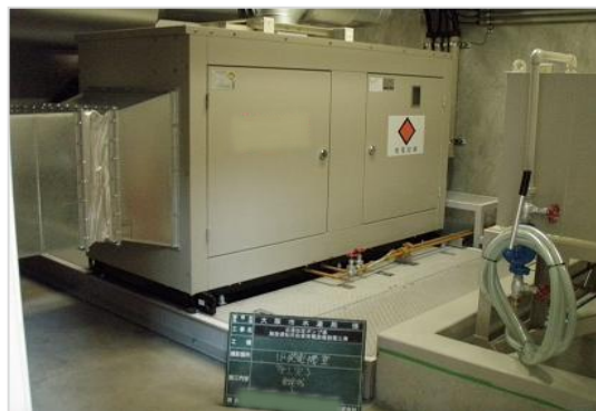
施設運転用自家発電設備（北港加圧ポンプ場）
