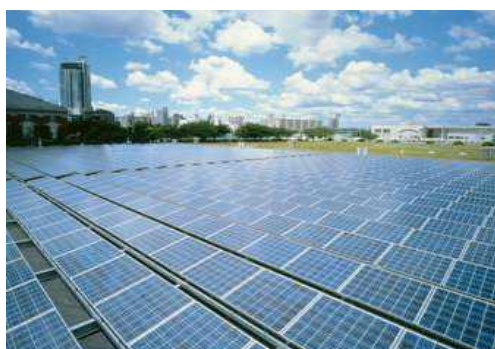
太陽光発電設備（柴島浄水場）
