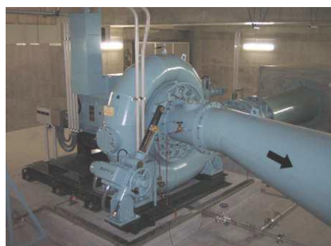
水力発電設備（長居配水場）
