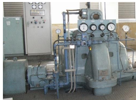
配水ポンプ（巽配水場）
