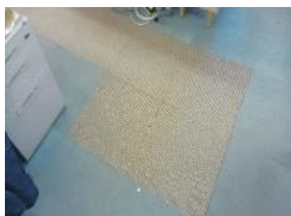
老朽化が進んだ旧フロアカーペット…
