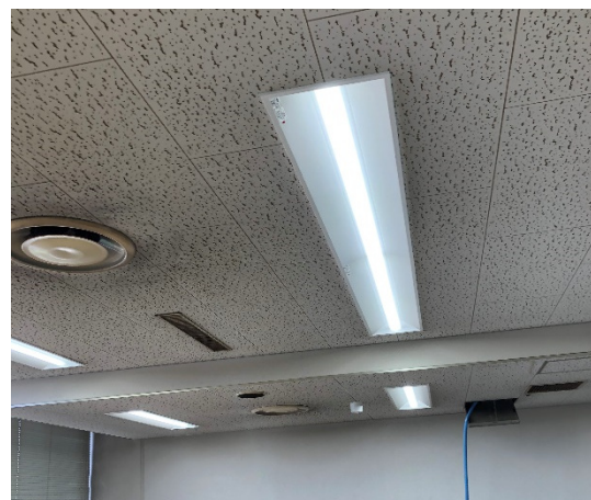
ESCO 事業による LED 照明の導入 (中部環境事業センター)
