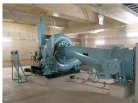
・平成16年度 長居配水場 ・平成25年度 泉尾配水場 ・平成30年度 咲洲配水場
