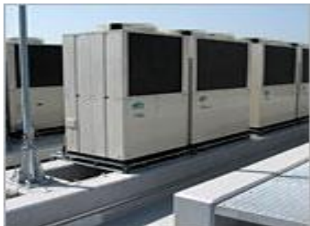
大型空調設備
