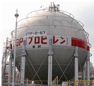
ガスプラント
