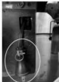
⑥充電コードリール破損 推測される原因：使用状況によるものと思われる
