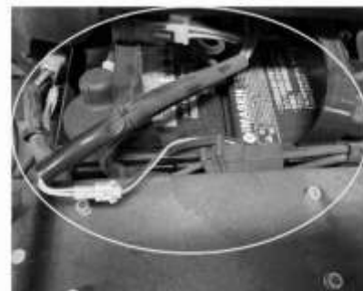
⑨配線類の劣化（硬化）が見受けられる 推測される原因：経年劣化
