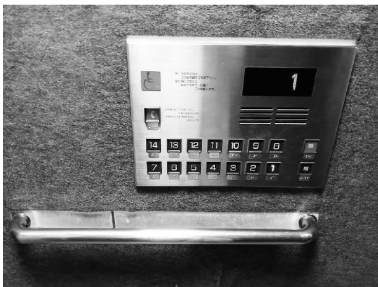
車椅子の方が押しやすい位置に設置されたかご操作盤エレベーター内にも手摺が設置
