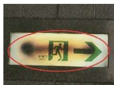
誘導灯の表示不良 ◆11
