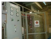
開放型電気室
