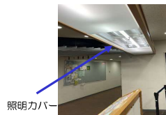
照明力バーの落下
