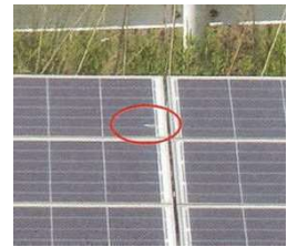
太陽光パネルの損傷❖9
