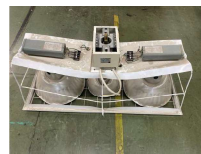
照明器具の落下
