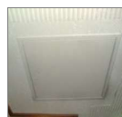
排煙口（通常閉鎖）
