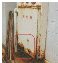
消火栓箱の損傷 ◆10
