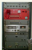
非常放送用アンプ
