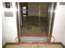
エレベーター扉の段差 12
