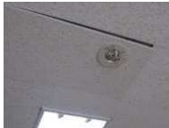
天井ボードの剥れ ※1
