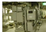
冷温水発生機
