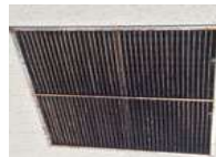
吹出口の錆と汚れ
