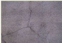
モルタルのひび割れ
