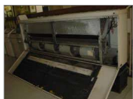
点検中のファンコイルユニット
