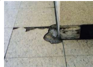
床仕上げ材の剥がれ
