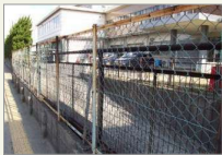
フェンスのさび
