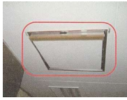
点検口の開閉不良 ※2
