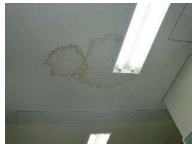
漏水による染み
