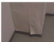
仕上げ材の剥がれ
