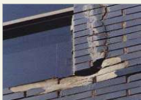
タイルの浮き・割れ
