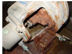
ポンプの腐食
