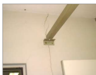
壁のひび割れ
