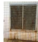
吸入口の腐食
