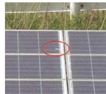
太陽光パネルの損傷❖9
