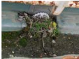
ルーフドレンの清掃不良
