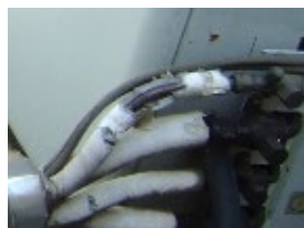
配管断熱材の剥れ
