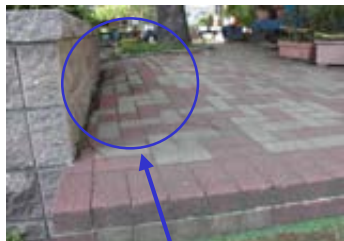
舗装の不陸や傾斜
