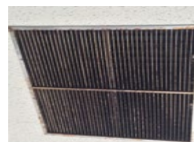
吹出口の錆と汚れ
