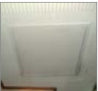
排煙口（通常閉鎖）
