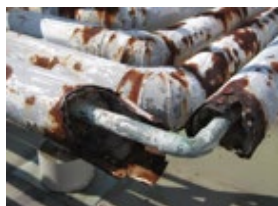
配管断熱材の損傷
