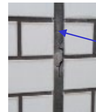
目地ひび割れ
