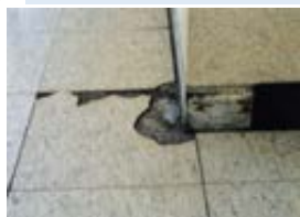
床仕上げ材の剥がれ
