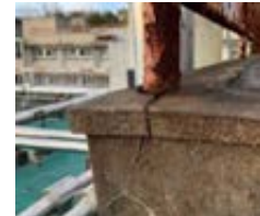
支柱部付近の損傷
