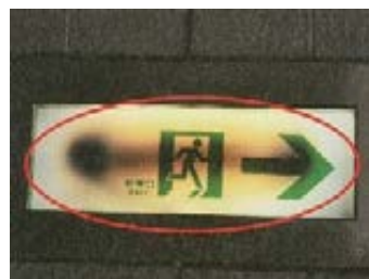
誘導灯の表示不良◆11
