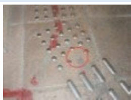
誘導鋲の欠損❖ 4
