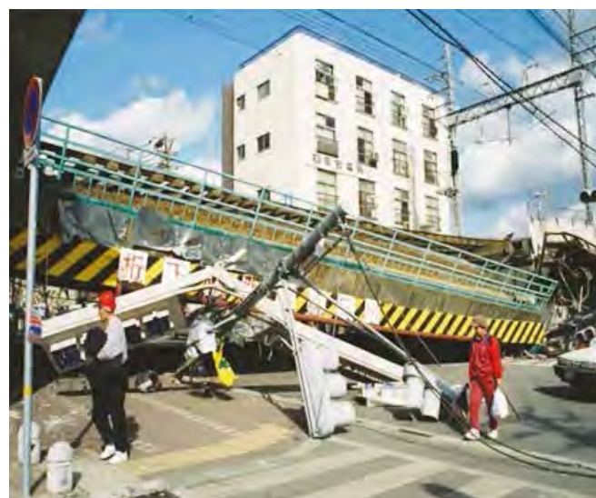
直下型地震の被害状況 揺れている時間は短いですが、強く激しく揺れて高い建物でも大きく破壊するものがある。
