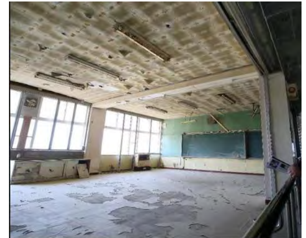
震災遺構 仙台市立荒浜小学校
