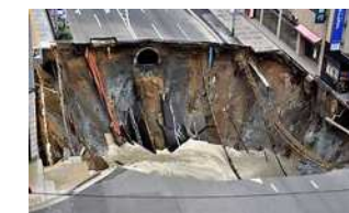
2016年8月 JR博多駅前の道路陥没事故
