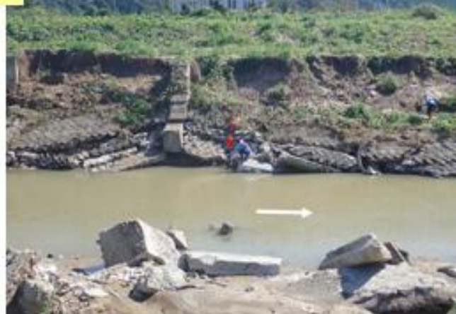
地震で隆起(3.5m)した場所で護岸が損傷
