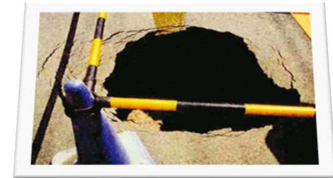
老朽化した下水道施設
