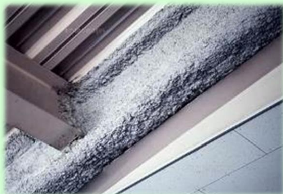
吹付け石綿 かつて、鉄骨の耐火性能向上などの目的で使用されていました。
