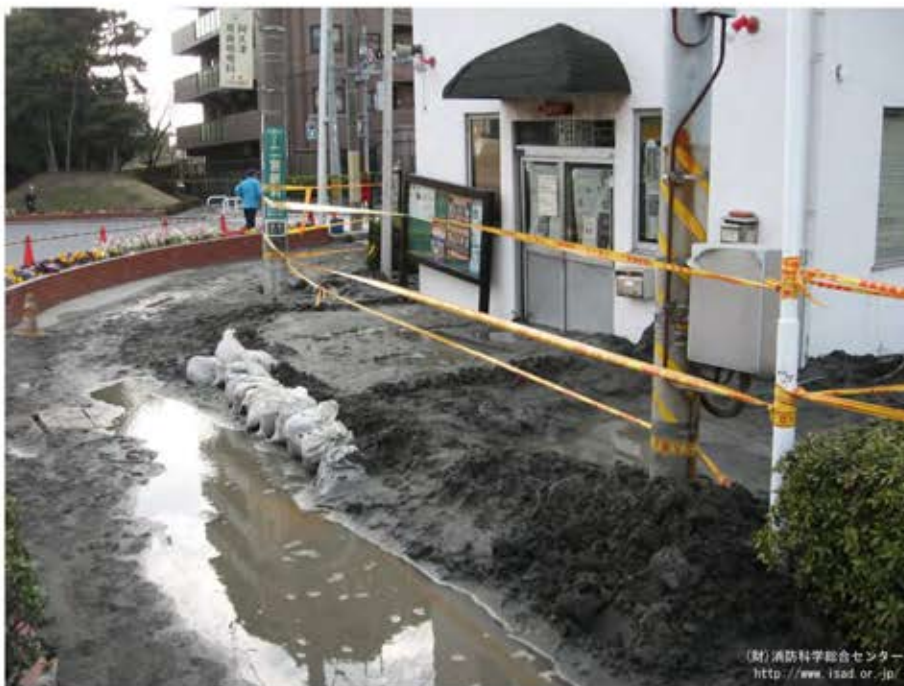
液状化被害（千葉県浦安市）
