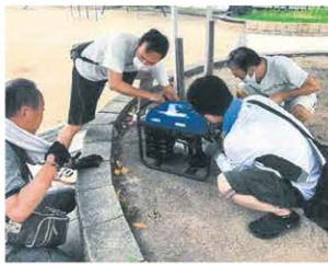
▲発電機の試運転
