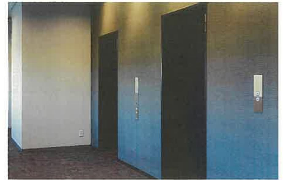
車いす対応エレベーター
