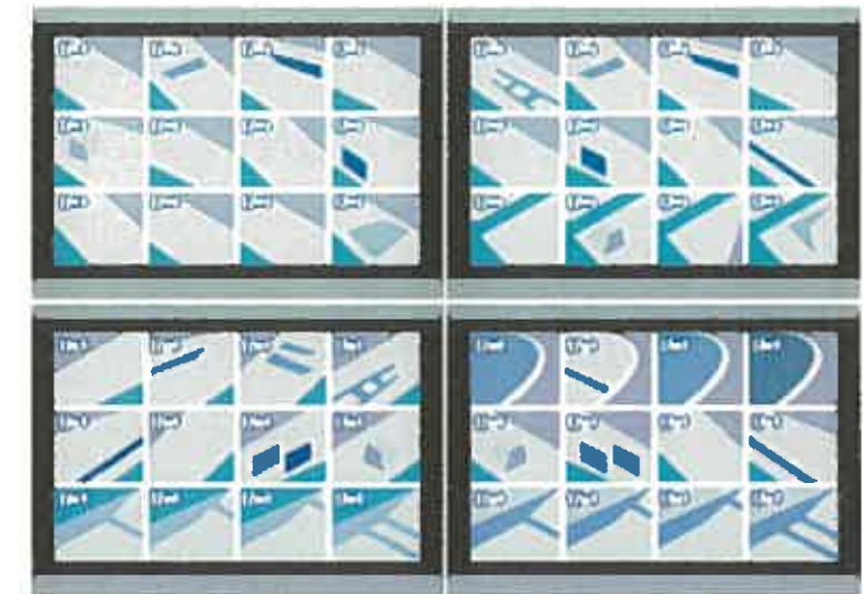
監視モニター(共用部)
