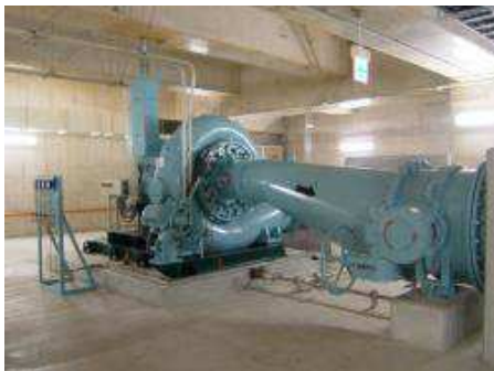
長居水力発電設備
