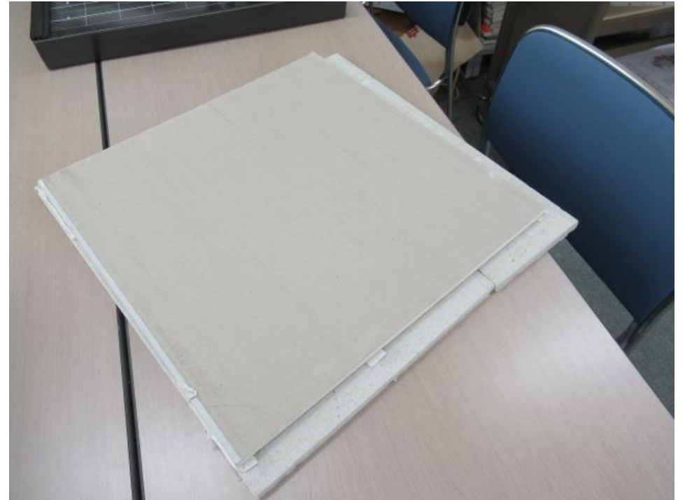
落下物（天井ボード）
