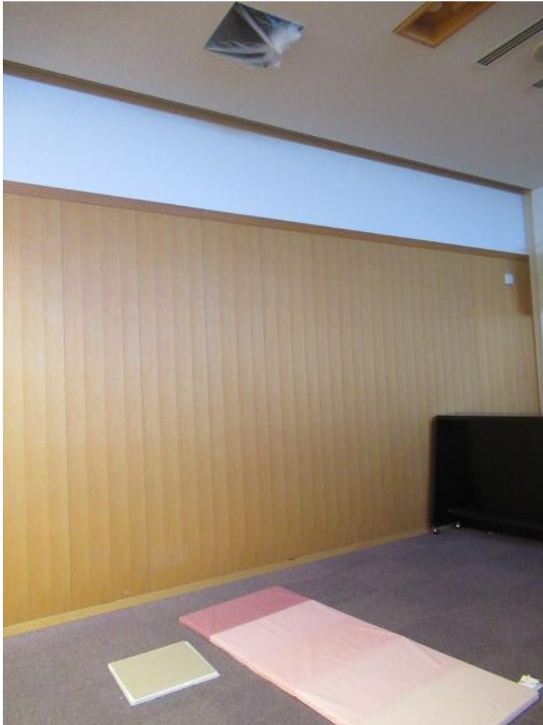
天井ボード落下場所
