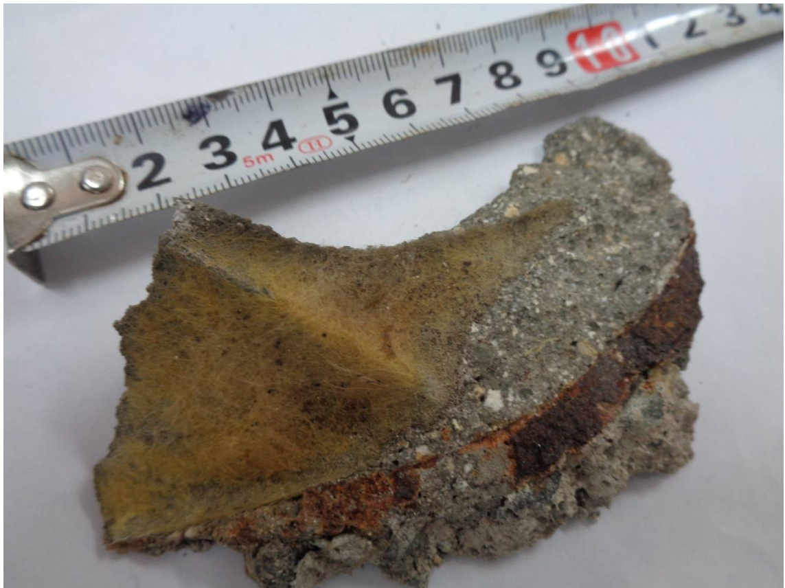
落下したモルタルの一部
