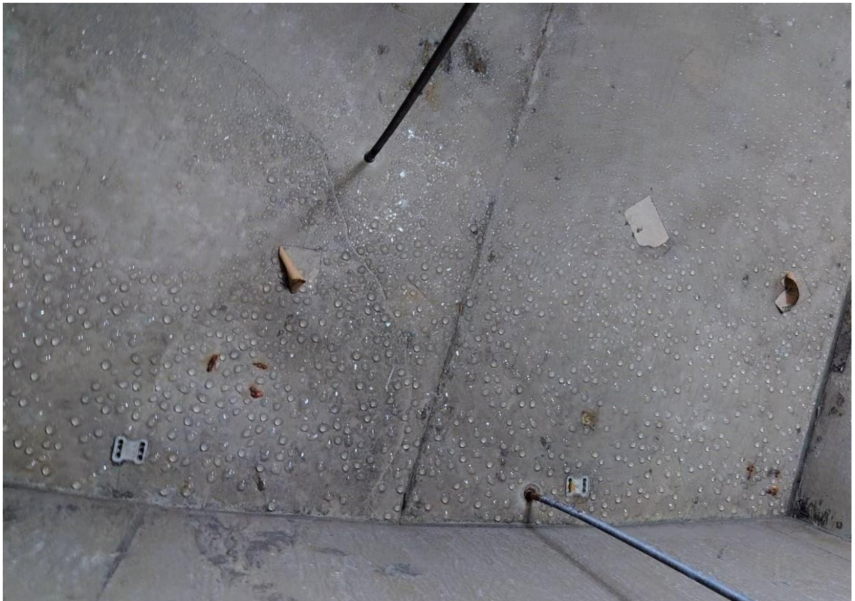
(イ) トイレ天井裏の結露の状況等
