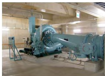
長居配水場の水力発電設備
