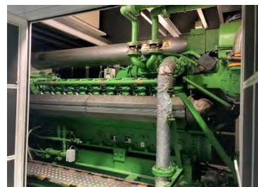
津守下水処理場の消化ガス発電設備
