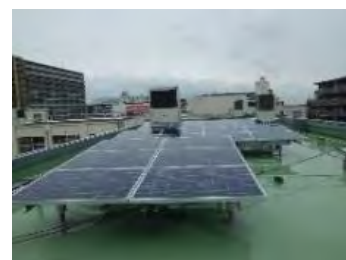
屋上に設置した太陽光発電設備
