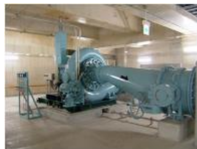
長居配水場の水力発電設備
