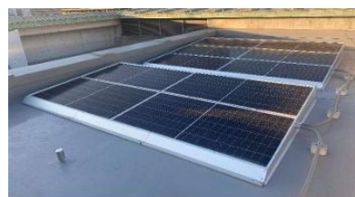
市役所本庁舎に設置した太陽光発電設備 (脱炭素先行地域づくり事業)
