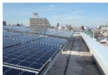
校舎屋上に設置した太陽光発電設備 (屋根貸し事業)
