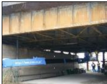
大型橋梁点検車
