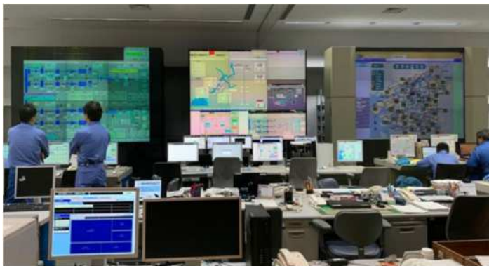
監視制御システム（総合水運用センター）
