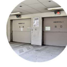
機械式駐車場
