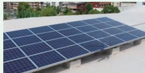
太陽光発電システム
