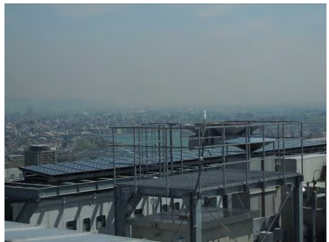
写真7 太陽光発電パネル
