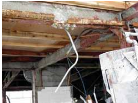
建物に残存した吹付け材
