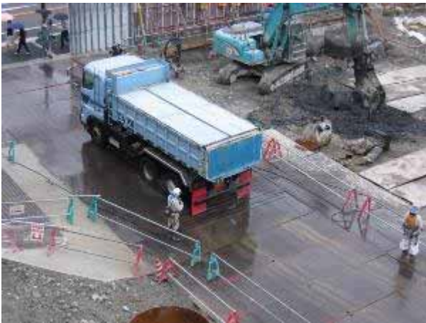
写真7 上蓋付き汚泥搬出車両とタイヤ洗浄 (車両による粉じんの飛散防止)
