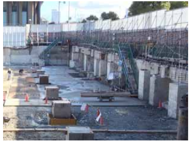
写真8 既存地下外壁の残置と山留壁として利用 (地盤沈下防止)
