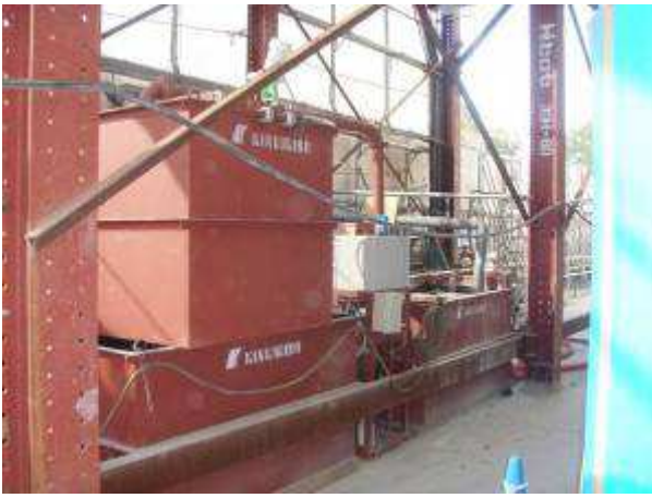
写真7 工事区域内の排水処理施設 (濁水への配慮)
