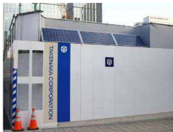
写真6 太陽光発電設備の設置 (CO 2 の削減)
