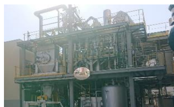
令和4年3月開始 次世代型廃棄物処理システム実証プラント（舞洲工場内）
