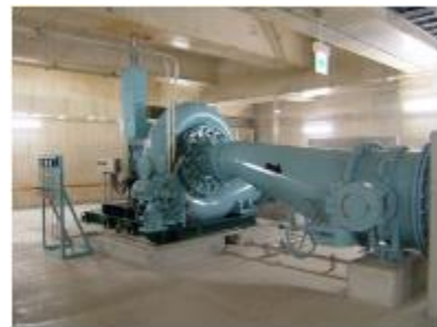
長居配水場の水力発電設備
