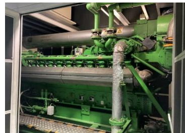
津守下水処理場の消化ガス発電機設備
