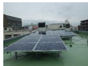
屋上に設置した太陽光発電設備
