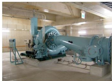
長居配水場の水力発電設備
