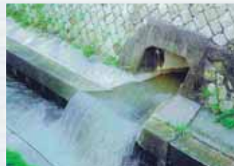
■雨天時の雨水吐き口
