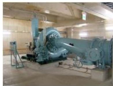
長居配水場の水力発電設備
