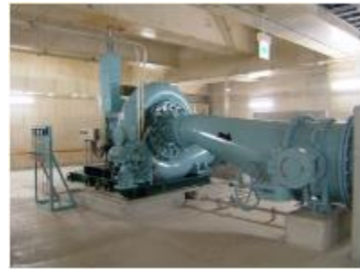
長居配水場の水力発電設備
