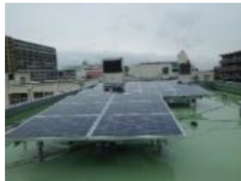
屋上に設置した太陽光発電設備
