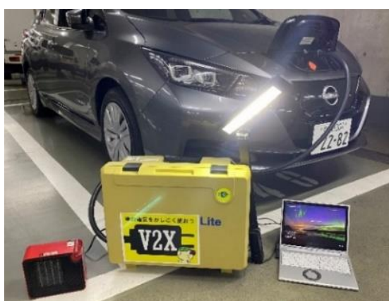
EV からパソコンや照明等への給電
