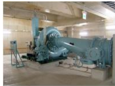
長居配水場の水力発電設備
