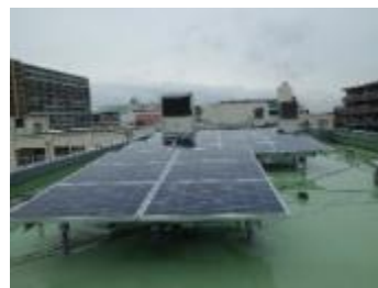
屋上に設置した太陽光発電設備
