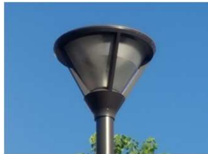
図 2 - 35 LED 照明 (公園灯)
