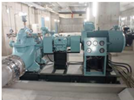
図 2 - 20 小水力発電設備（泉尾配水場）
