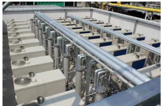
図 2 - 14 消化ガス発電施設（大野下水処理場）
