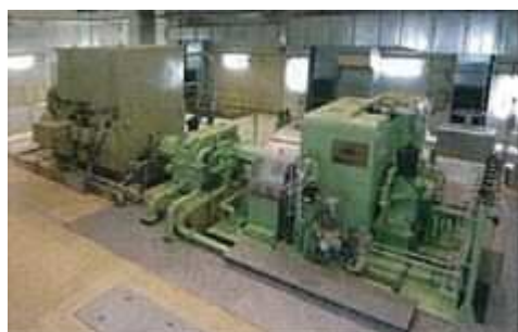
図2-10 発電設備(東淀工場)
