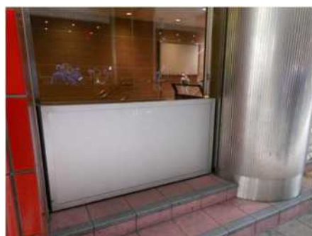
図3 - 17 出入口止水扉（地下街）
