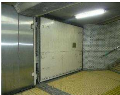
図3 - 16 出入口止水扉（地下鉄）
