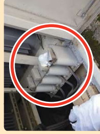
キュービクル内に設置された 低圧コンデンサー
