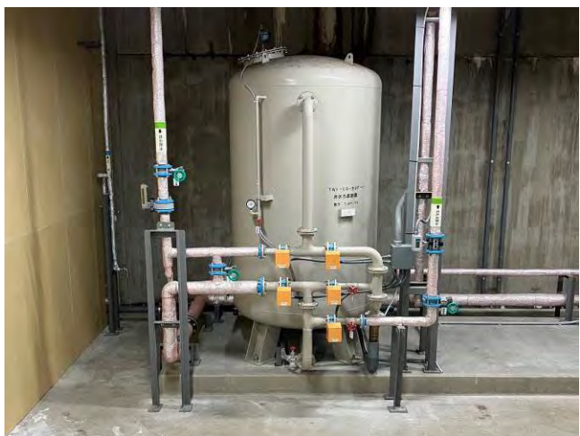
写真 2 井水ろ過施設
