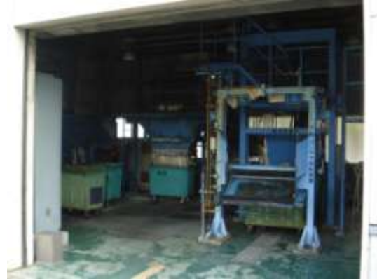
○排水処理施設
