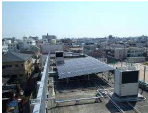
太陽光パネル設置（中川小学校：生野区）
