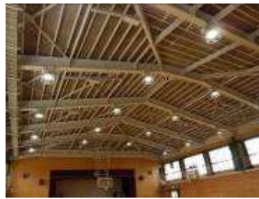
LED照明(港中学校:港区)
