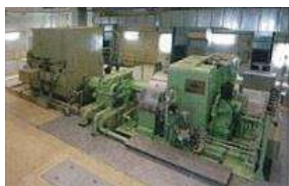
発電設備（東淀工場）
