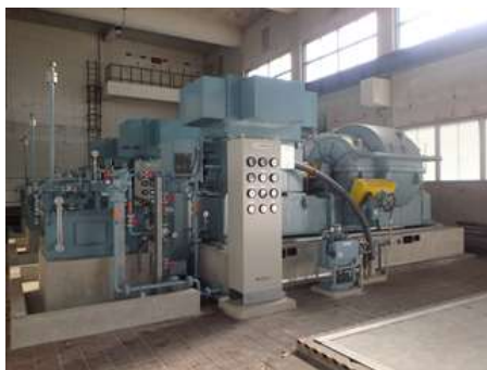
送風機（ブロワ）（平野下水処理場：平野区）
