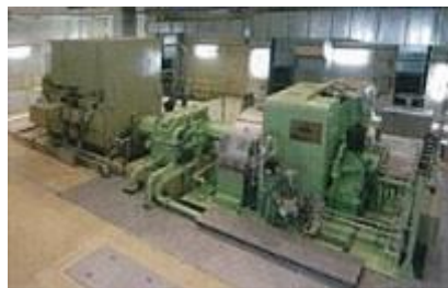
発電設備（東淀工場）
