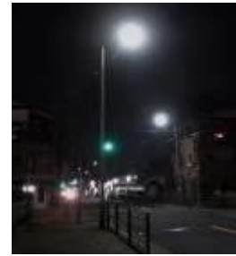
道路照明灯のLED照明
